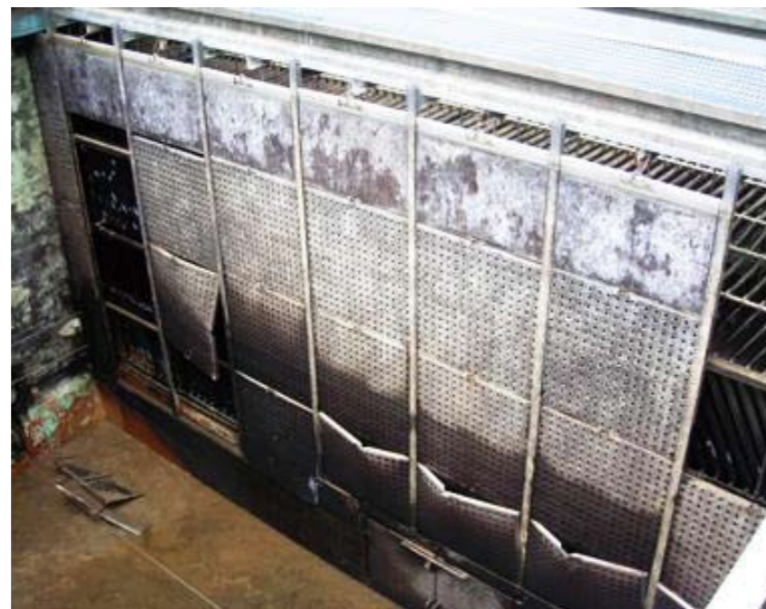
福岡沈澱池整流板脱落被害
