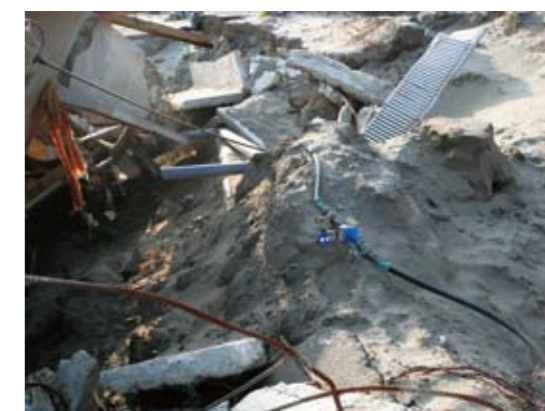
津波による給水装置被害(若林区荒浜)
