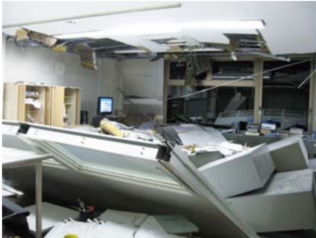
国見庁舎の被害
