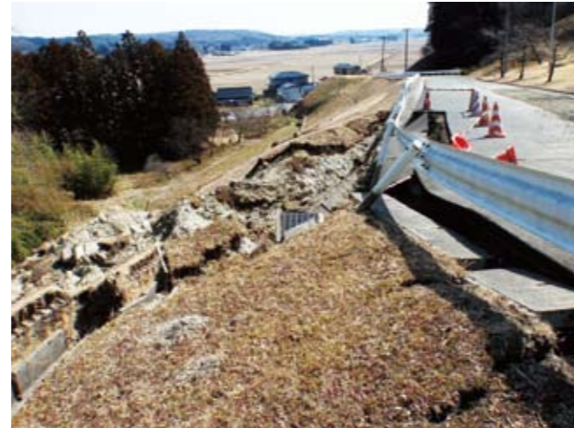
福岡浄水場進入路の法面崩壊
