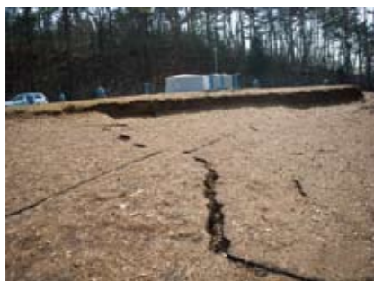
吉成配水所の地割れ、法面崩落
