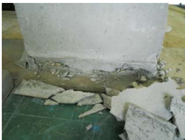
国見浄水場ろ過池建屋支柱損傷
