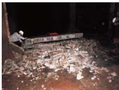
安養寺配水所導流壁倒壊
