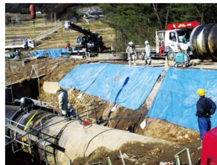
宮城県仙南・仙塩広域水道の修繕工事(口径2,400mm) (宮城県企業局提供)
