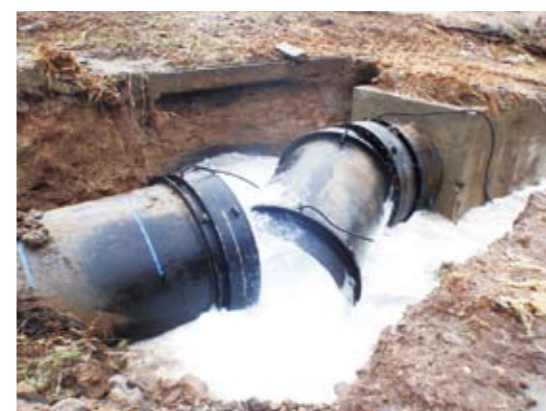
宮城県仙南・仙塩広域水道の破損(口径2,400mm) (宮城県企業局提供)
