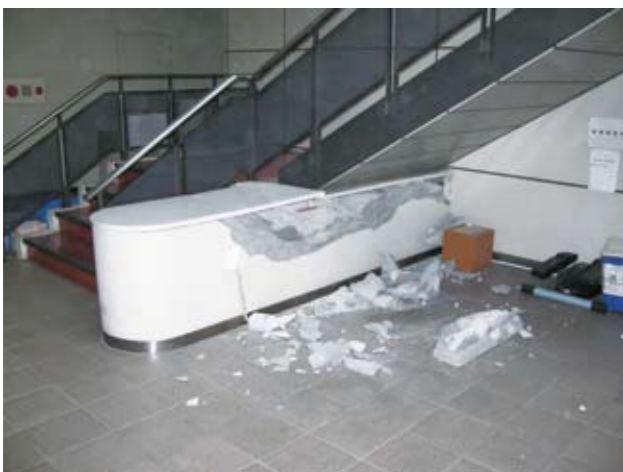
卸町庁舎の被害
