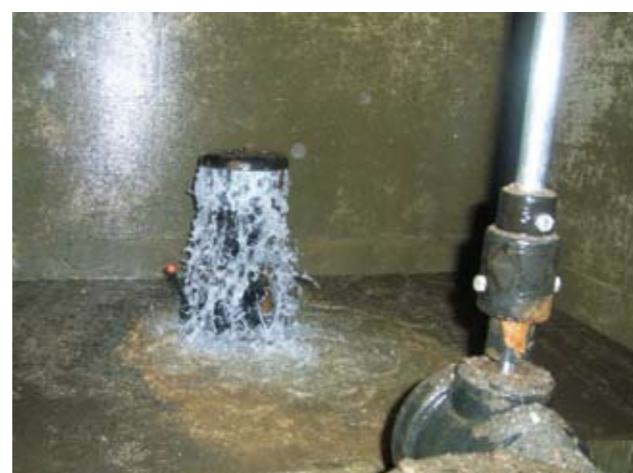
空気弁からの漏水
