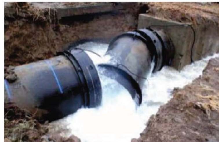
宮城県仙南・仙塩広域水道の送水管の破損 (口径2,400mm) (宮城県企業局提供)
