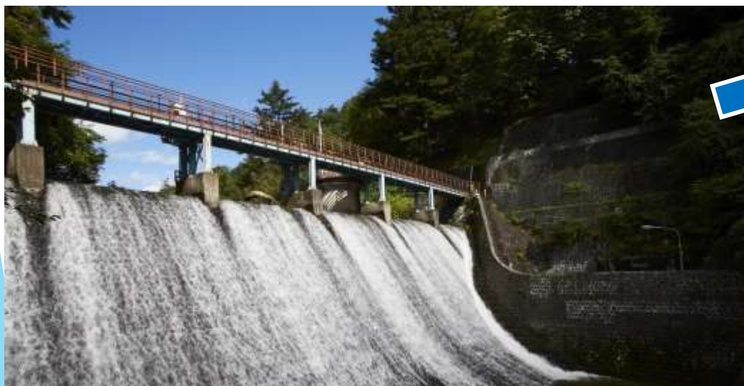
青下ダム 水源水量：11,750m 3 /日
