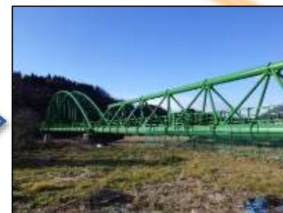
水管橋(送水管)
