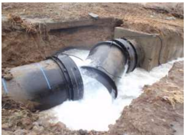
2.4mの伸縮可とう管がはずれ漏水
