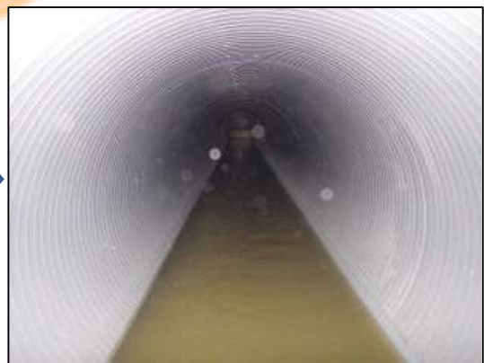
下水道管 (流域下水道管渠)
