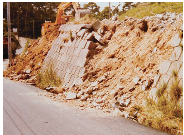
宮城県沖地震による法面の崩壊
