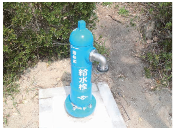
災害時給水栓
