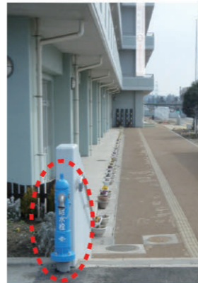
七北田小学校に設置した災害時給水栓
