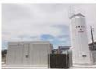
機器ユニット・水素タンク
