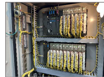
茂庭浄水場管理室 PLC
