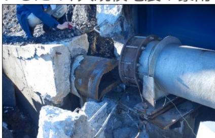
地震により破断した水道管(令和6年能登半島地震)
