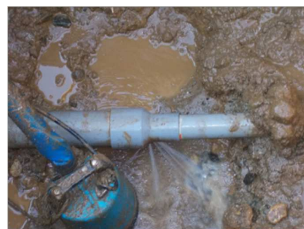
地震による老朽管の破損
