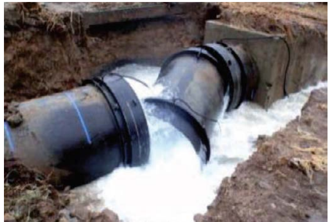
宮城県仙南・仙塩広域水道の送水管の破損（口径2,400mm） (宮城県企業局提供)
