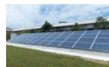
太陽光発電設備
