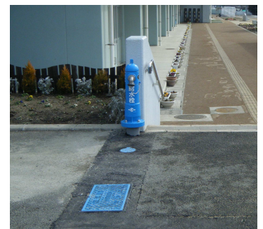
災害時給水栓
