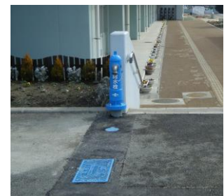
災害時給水栓
