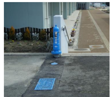
災害時給水栓
