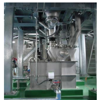
粉末活性炭注入設備
