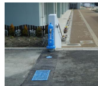
災害時給水栓
