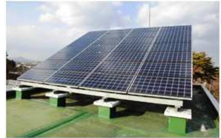
太陽光発電設備
