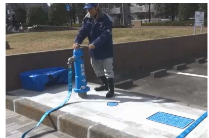
災害時給水栓
