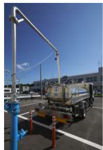
給水車用注水補給設備
