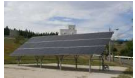
太陽光発電設備
