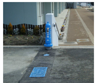
災害時給水栓
