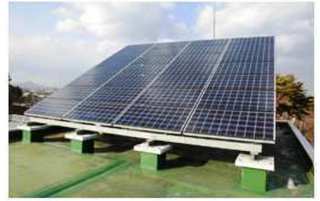
太陽光発電設備
