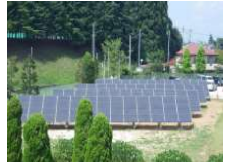
太陽光発電設備
