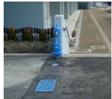
災害時給水栓
