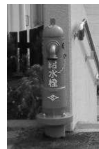
<災害時給水栓>
