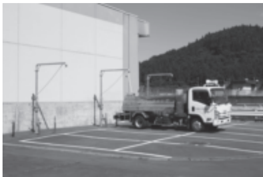
<茂庭浄水場注水補給設備>
