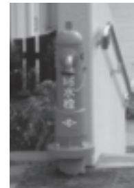
<災害時給水栓>
