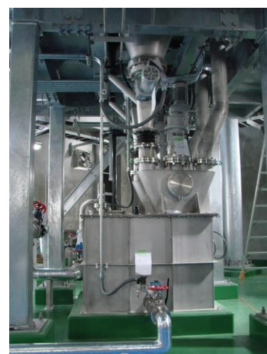
粉末活性炭注入設備
