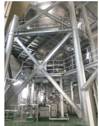
粉末活性炭注入設備
