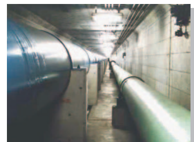
中央配水幹線
