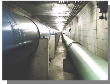
【中央配水幹線】
